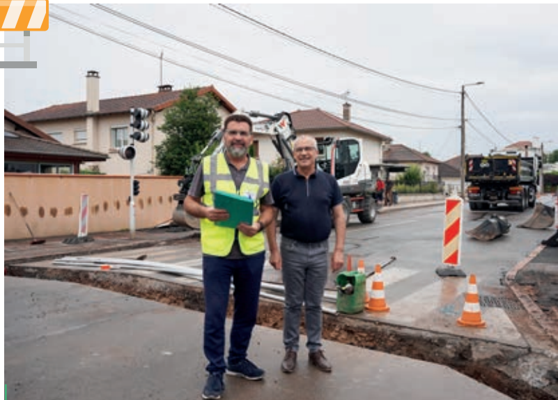
VISITE DE CHANTIER. Michel Vassoille et Jean-Luc Mardeuil, respectivement responsable et adjoint à la voirie.
